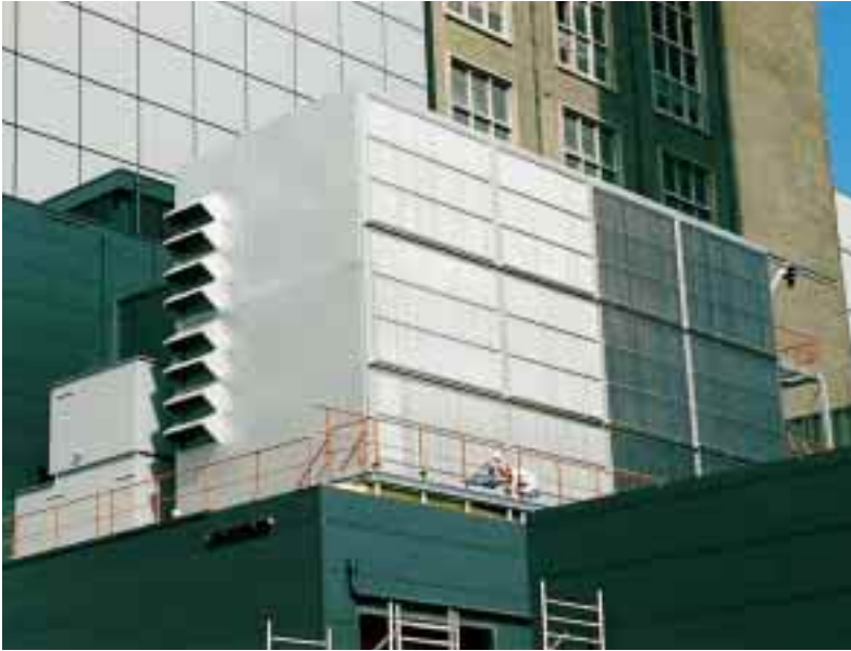
Zuluftanlage (ca. 1.500.000 m 3 /h)
