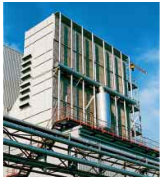
Zuluftanlage (ca. 1.500.000 m 3 /h)
